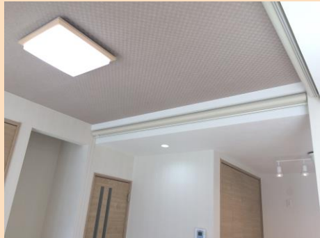
畳スペースの天井・縁に取付けられたロールスクリーンがスタンバイ☆
